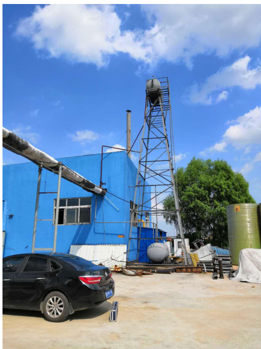
图 6-6 天然气锅炉废气排气筒 P2
