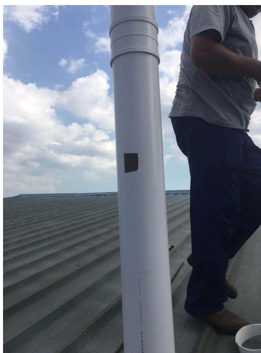
图 6-7 食堂油烟排气筒 P3 及检测口
